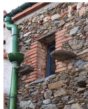
Puig del Mas. Pierres plates pour support de pots en céramique (parfois pour le dessalage de la morue)
